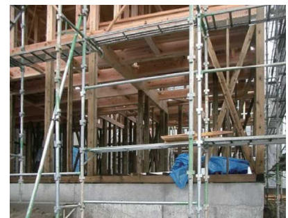
1 階部の木製部材全てに防腐剤注入を使用した住宅の例
